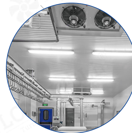
冷库/冷链 通风制冷系统
