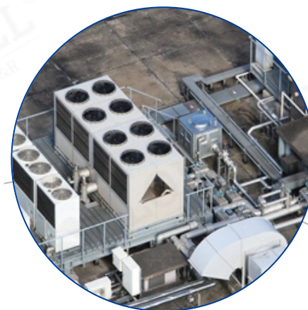
楼宇空调通风系统
