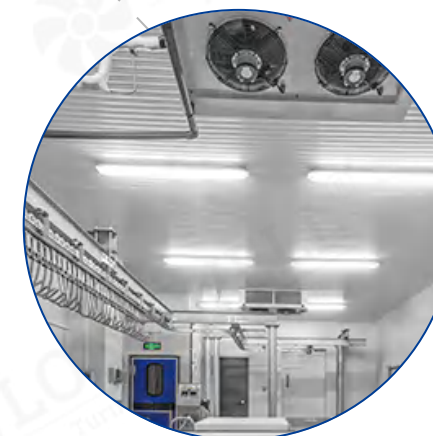
冷库/冷链 通风制冷系统
