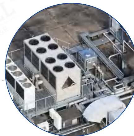
楼宇空调通风系统
