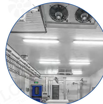
冷库/冷链 通风制冷系统
