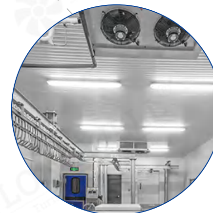
冷库/冷链 通风制冷系统
