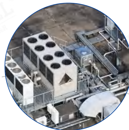
楼宇空调通风系统
